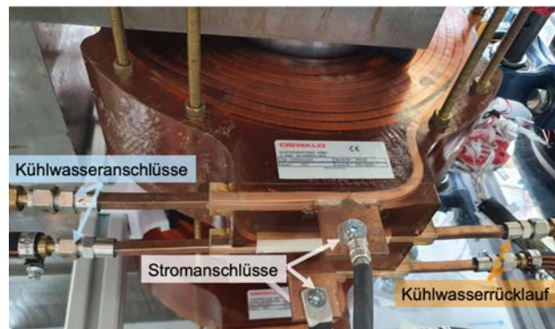
Abb. 3.12: Wassergekühlte Erregerspulen aus Kupferhohlleitern mit markierten Kühlwasseranschlüssen für Zulauf und Rücklauf über das hausinterne Kühlsystem sowie dem Stromanschluss. Die Wasserkühlung dient der Langzeitkonstanz des erzeugten Magnetfelds.
