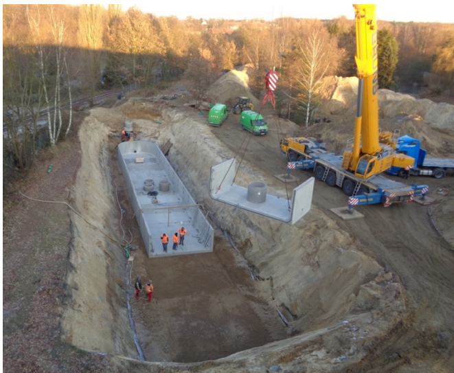
Abbildung 10: Bebauungsplan Nr. 135 (1. Änderung) Am Meisterweg: Regenrückhalteanlage. Niemann 2018
