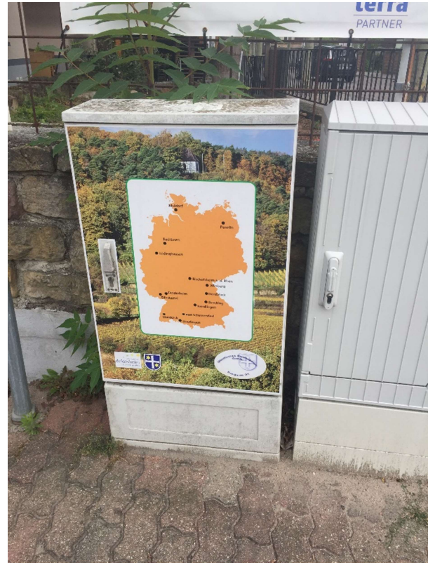
Abbildung 13: Stromkasten Deidesheim. Quelle: eigene Aufnahme.
