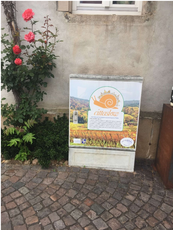
Abbildung 12: Stromkasten Deidesheim. Quelle: eigene Aufnahme.
