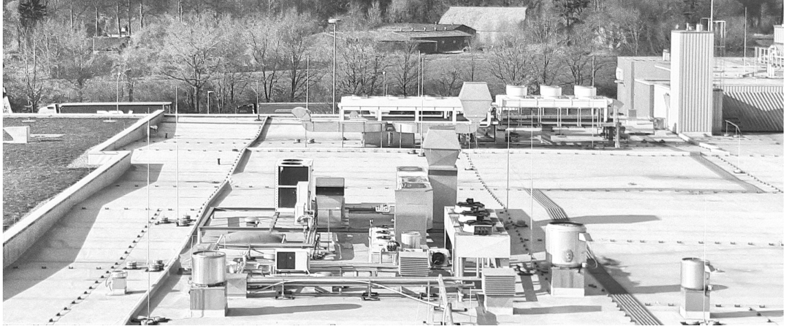
Abbildung 55: Technische Anlagen eines Einkaufszentrums 500
