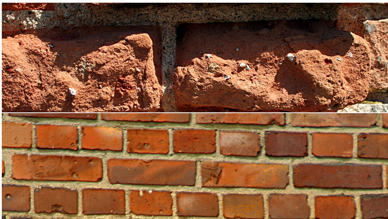
Abb. 4.2: Spuren ungenügender Tonreinigung Gebäude: Wohnhaus Ziegelei Neuwendhausen (o); Henningstr. 4 (u) Fotos: Seidel.
