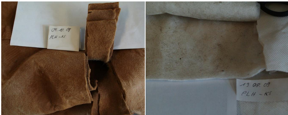
Abb. 4.4.6: Filterstrümpfe aus der Kältespeicheranlage, entnommen im Paul-Löbe-Haus (PLH) im Oktober 2008 (l.) sowie im August 2009 (r.) im Vergleich. Deutlich ist die stärkere Beladung des im Oktober 2008 entnommenen Filters zu sehen.
