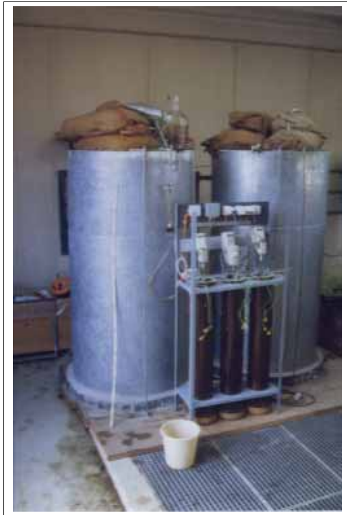
Abbildung 9: Versuchsanlage zur Simulation des Aquiferwärmespeichers der Universität Stuttgart
